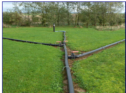
Photo 19 : Réseau de captage sur site réaménagé
