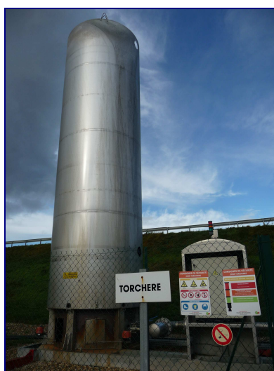
Photo 7 : Zone technique destinée au biogaz
