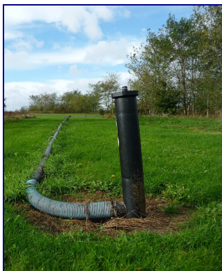
Photo 18 : Puits de captage de biogaz
