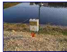
Photo 8 : Coupure pompe au niveau du bassin lixiviats
