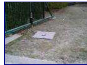
Photo 2 : Arrivée générale d'eau sur le site
