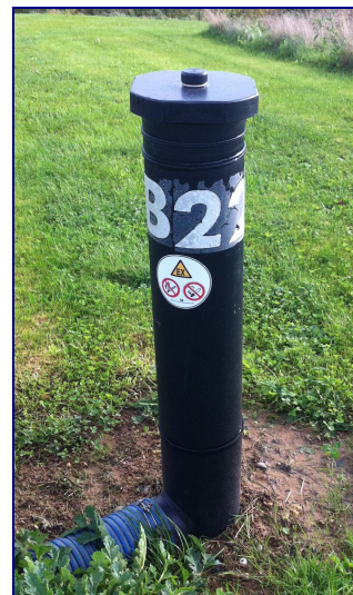
Photo 11 : Puits de biogaz et sa signalisation ATEX
