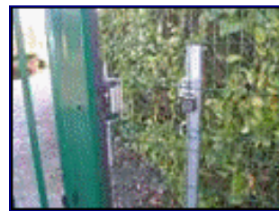
Photo 26 : Alarme de détection d'intrusion
